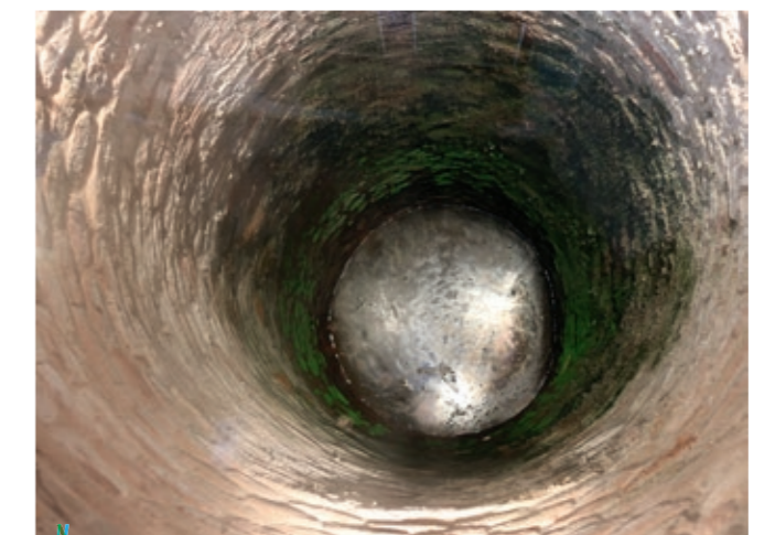
Foto. Steenput van De Grote Sterre in Damme. De precieze leeftijd is niet gekend. Dertiende-eeuws zoals de kelders van het pand is onwaarschijnlijk, want er zijn geen moefen gebruikt. Vijftiende-eeuws is mogelijk, maar de put kan ook later heropgemetst zijn. Het huidige grondwaterpeil bevindt zich op ongeveer 5 m diepte. De bodem van de put kon nog niet onderzocht worden. Op het water drijft een duidelijke ijzerbacteriënfilm. Foto Arnout Zwaenepoel, 2019.
